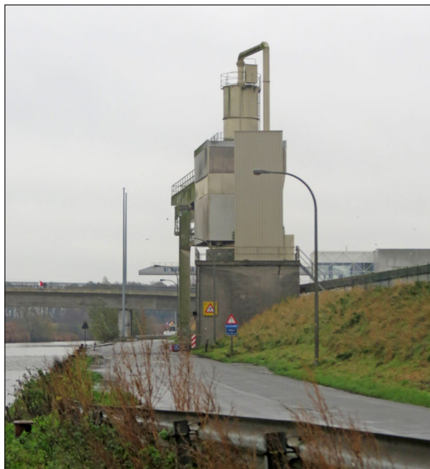
De laad- en losinstallatie aan de kade van AVEVE
