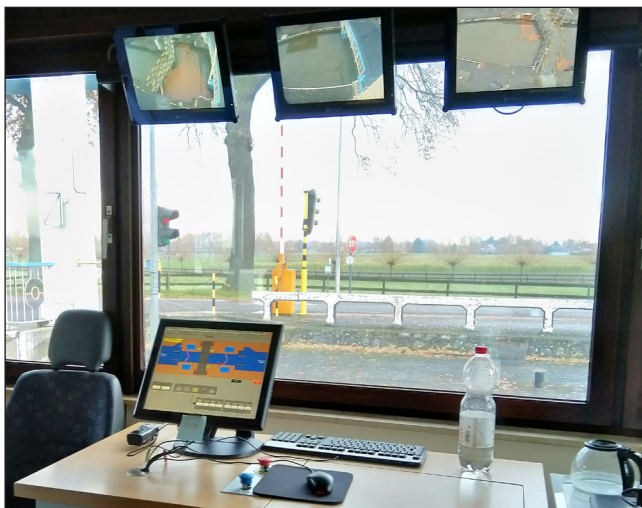
De Vlaamse Waterweg nv bedient de sluizen op de bevaarbare waterlopen in Vlaanderen. De foto toont de sluisbediening in Bocholt sluis 18.
