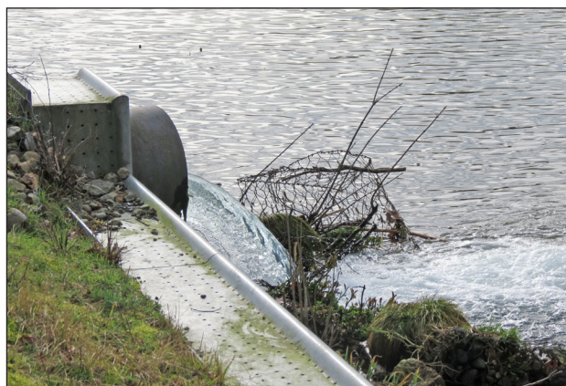
Effluent van de verdeelput in de Zuid-Willemsvaart. Helder opgepompt grondwater uit de mijnverzakking van Eisden wordt in het kanaal geloosd.
