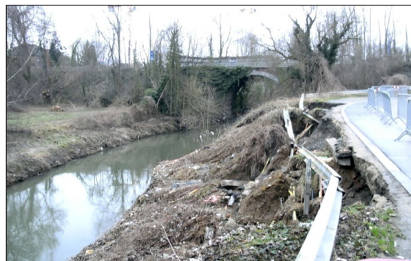
Overstromingen november 2010 - verzakte oever van de Zenne ter hoogte van bouwmaterialenbedrijf Denayer in Halle.
